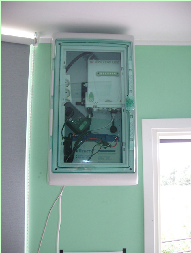
Tõravere GNSS receiver
