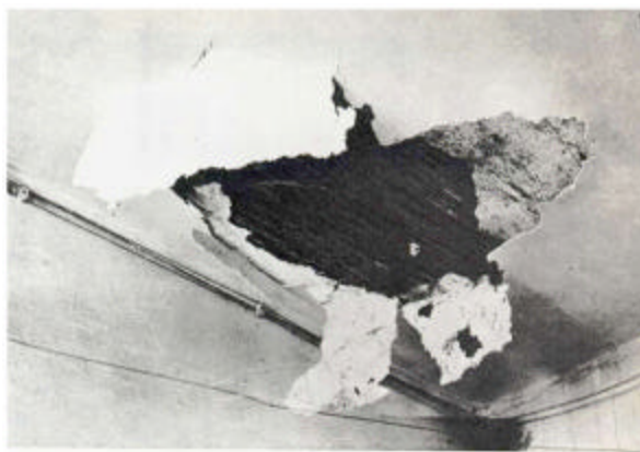
7-17 丰顺县官田公社一平街内喷沙冒水，冲塌了房屋顶棚(10度区)。
